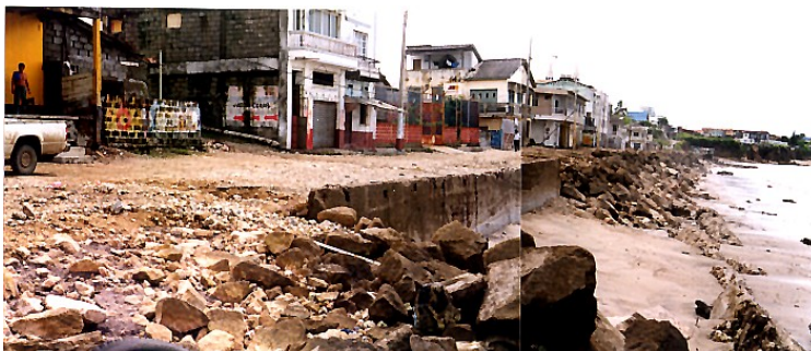
Foto 4.- Antiguo muro de contención, de concreto, del balneario La Libertad, completamente destruido.
